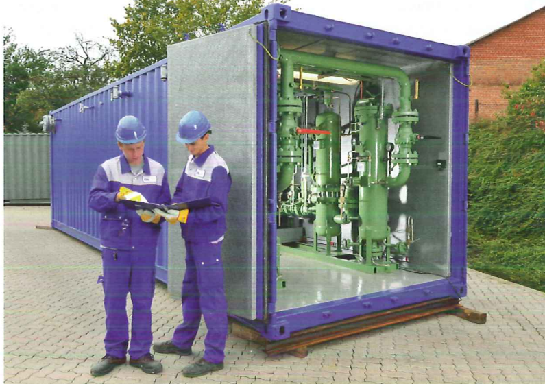
Mobile und mietbare GDR-Anlagen garantieren die Gasversorgung auch bei Wartungs- und Instandsetzungsmaßnahmen.
